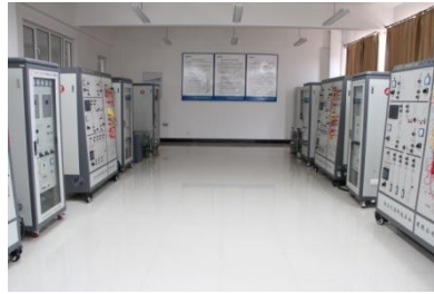
工厂变配电实训室
